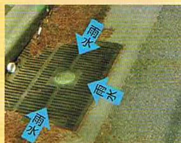
雨水で道路脇に落葉や土砂が堆積している例
