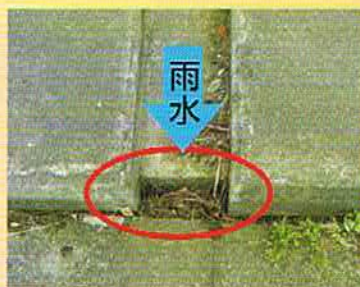
雨樋からの排水先に落葉や土砂が堆積している例
